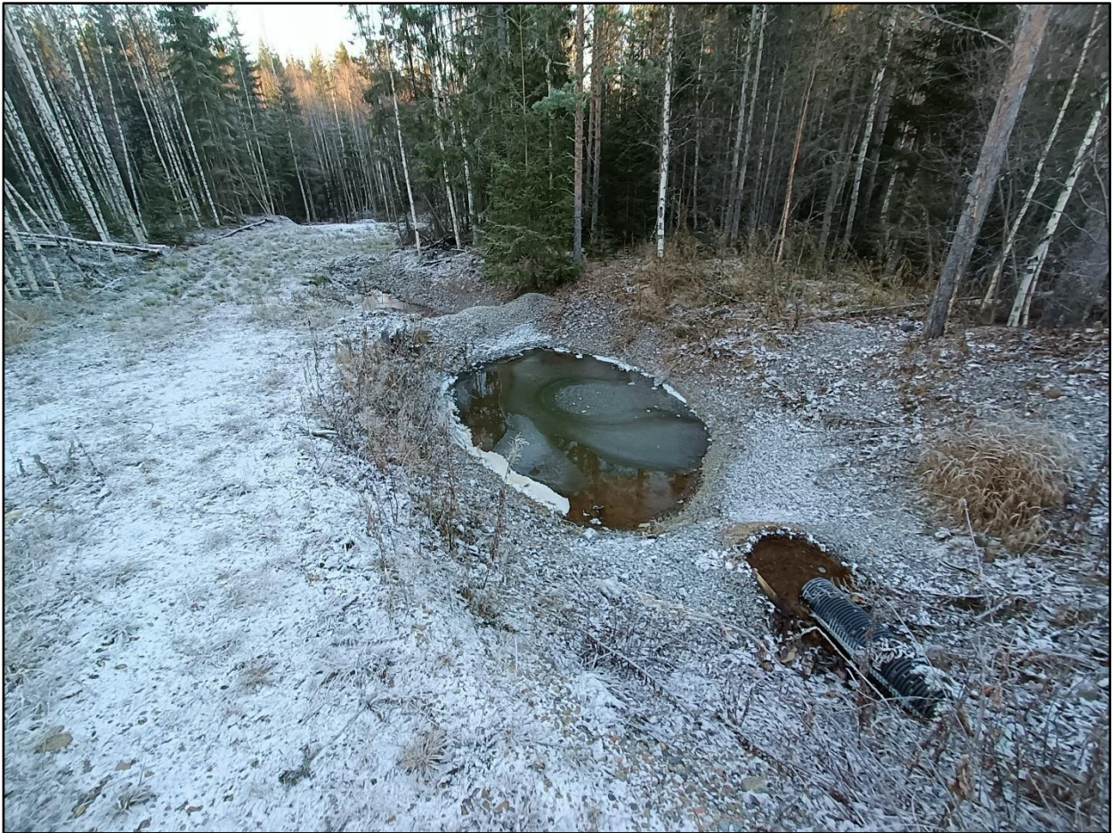
Kuva 10. Jälkimmäiset laskeutusaltaat. (27.10.2023, SGM:n oma kuvagalleria.)
